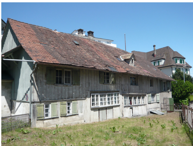
Die Fischerhäuser in Romanshorn TG vor der Renovation. (Foto: Stiftung Ferien im Baudenkmal )
