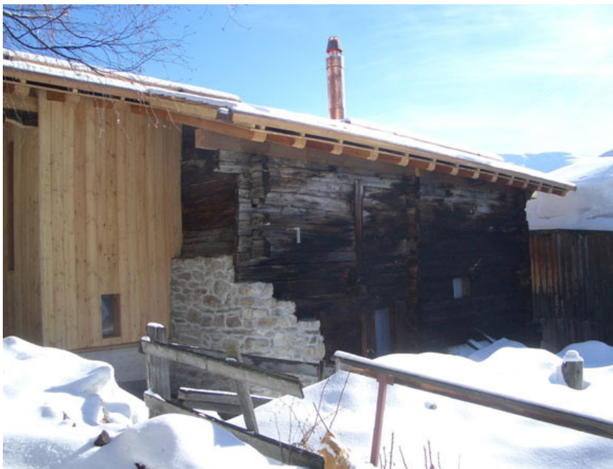
Das Huberhaus in Bellwald ist das erste Haus der Stiftung Ferien im Baudenkmal , das renoviert wurde und nun vier Gästen für Ferien zur Verfügung steht. (Foto Schweizer Heimatschutz)
